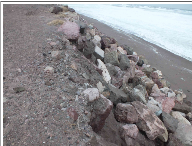
Effondrement amont (zone parking)
