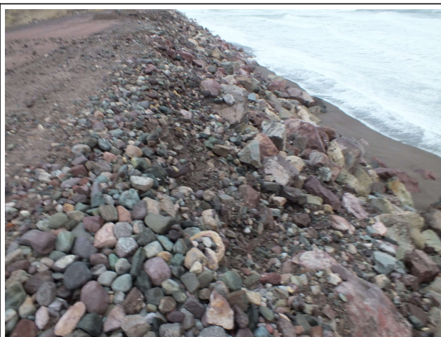
Érosion en tête de talus côté amont
