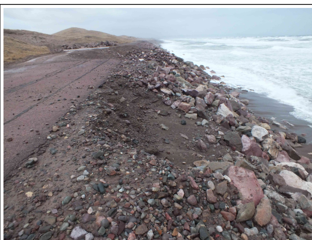
Érosion de la tête de talus avant l'effondrement central
